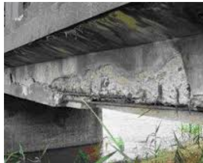
(b) kerusakan selimut beton balok jembatan akibat korosi tulangan memanjang
